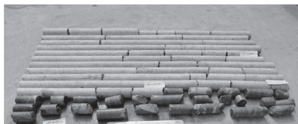
图3-1 5-93#桩桩芯样图片
